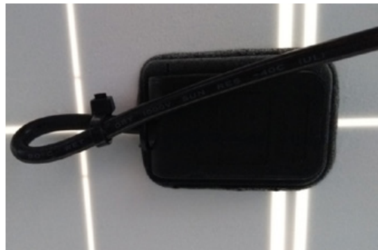
図9: ジャンクションボックスから延びるケーブルを鋭角に曲げた例
