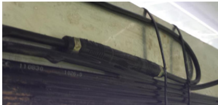
図10: コネクタを架台にぴったり固定すると、コネクタとレールの間に湿気が滞り、接続部が破損する可能性があります。
